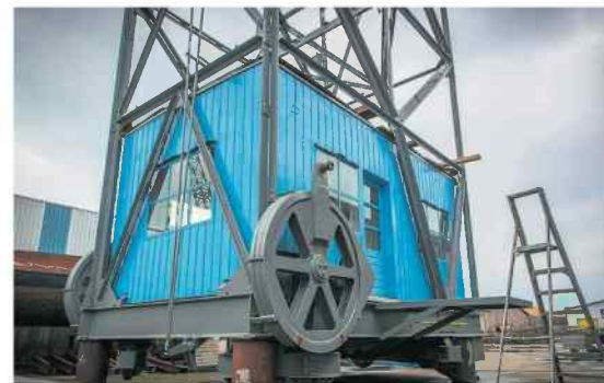
Structural Franeker bouwt op dit moment een oude kraan in Amsterdam om tot hotel. Het lierenhuis wordt een van de kamers. FOTO DVHN/ROELOF VAN DALEN
